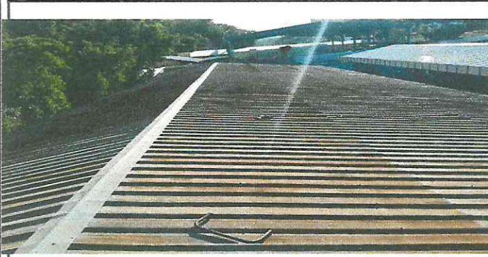
Foto 1. Vista del deterioro de lamina de los módulos a intervenir.
