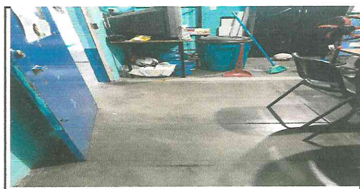
Foto 6: Vista de Piso de Concreto a reemplazar en Dirección
