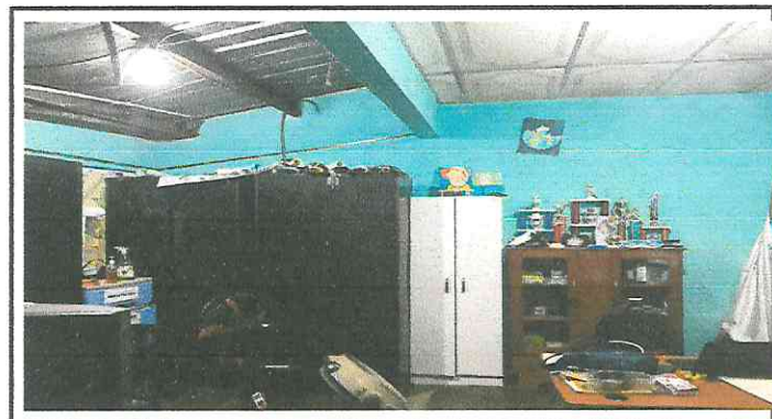
Foto 4: Vista interna Cielo Falso Deteriorado.
